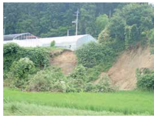
▲崖崩れ(桜渡戸地区)
