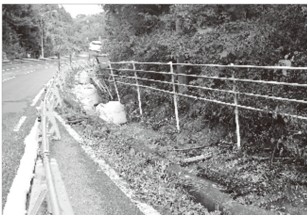
台風第19号大雨による道路陥没（長老坂）
