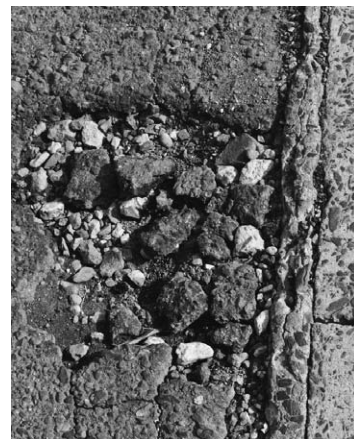
道路の陥没箇所
